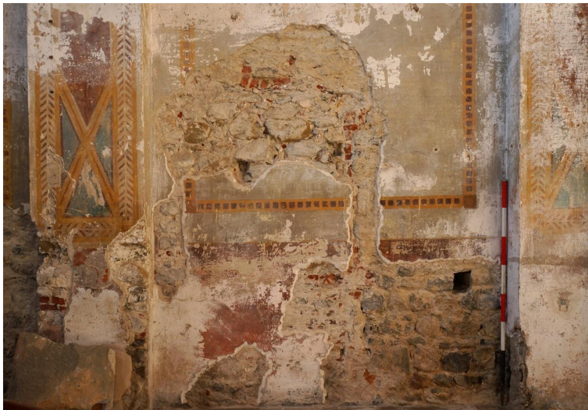
Figura 3. Le diffuse tracce di intonaco dipinto sul perimetrale nord (PPV).
