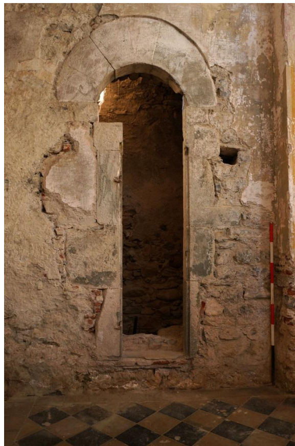
Figura 13. L'apertura EA5, realizzata contestualmente al perimetrale nord ma in seguito pesantemente rimaneggiata.
